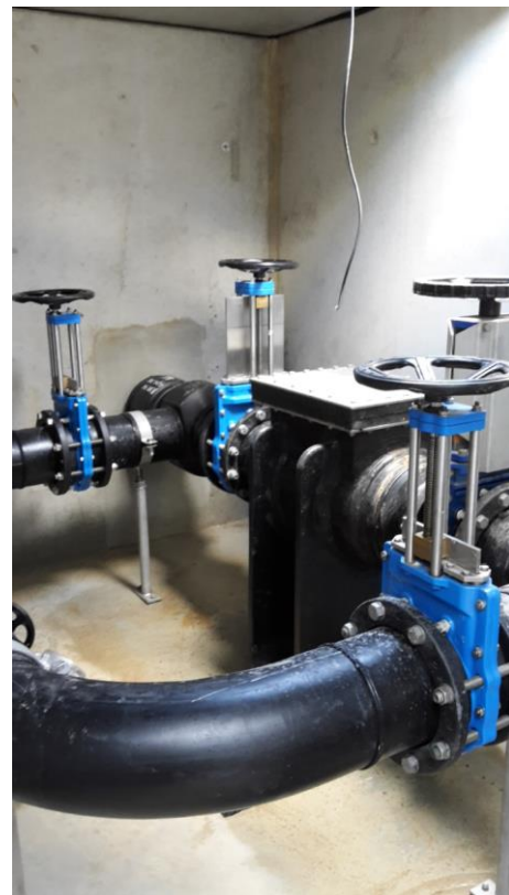
Bild 1: Molchschleuse mit Umfahungsleitung
